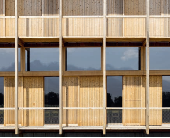
Les éléments de façade fixes sont déterminants pour la protection thermique estivale.
