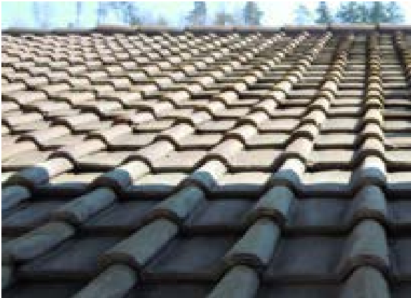
Abb. 0 Gut und keine Frostschäden: Wenn man solches Deckmaterial antrifft, kann man eine Solaranlage planen, wenn auch die Unterkonstruktion in gutem Zustand ist.
