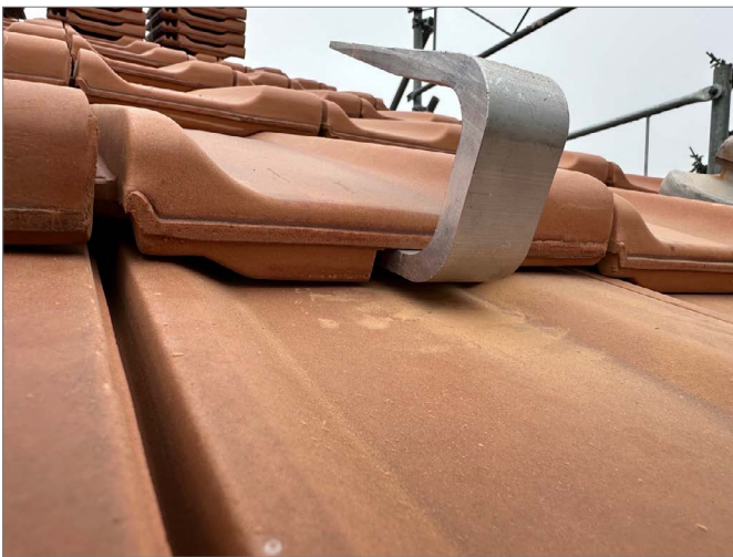
Abb. 7 Die Rippen am Flussschluss werden mit einer Trennscheibe eingeschritten und mit einem Ziegelhammer sorgfältig entfernt.
