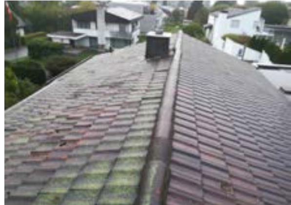
Abb. 13 Einzelne abgesplitterte Ziegel: Hier empfiehlt sich eine Dachreparatur vor der Ausführung
