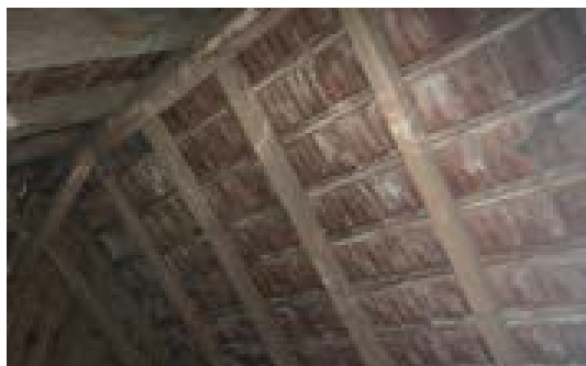
Abb. 17 Kein Unterdach Spätere Dachmodernisierungen sollten in die Planung einer Solaranlage miteinfließen.
