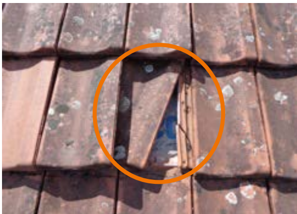
Abb. 12 Wichtig: Auch bei gutaussehendem Deckmaterial können verdeckte Mängel vorhanden sein!
