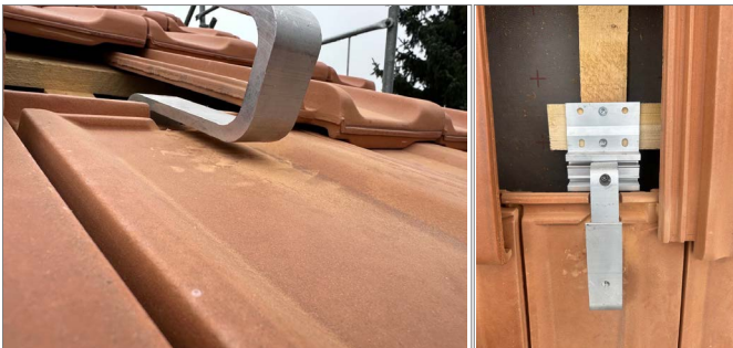
Abb. 6 Die Rippen des Kopfschlusses werden mit einer Trennscheibe eingeschritten und mit einem Ziegelhammer sorgfältig entfernt. Haken soll ca. 5 mm Abstand zum Deckmaterial haben.
